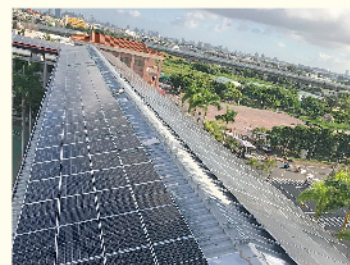
太陽光電設備(東棟屋頂型)
